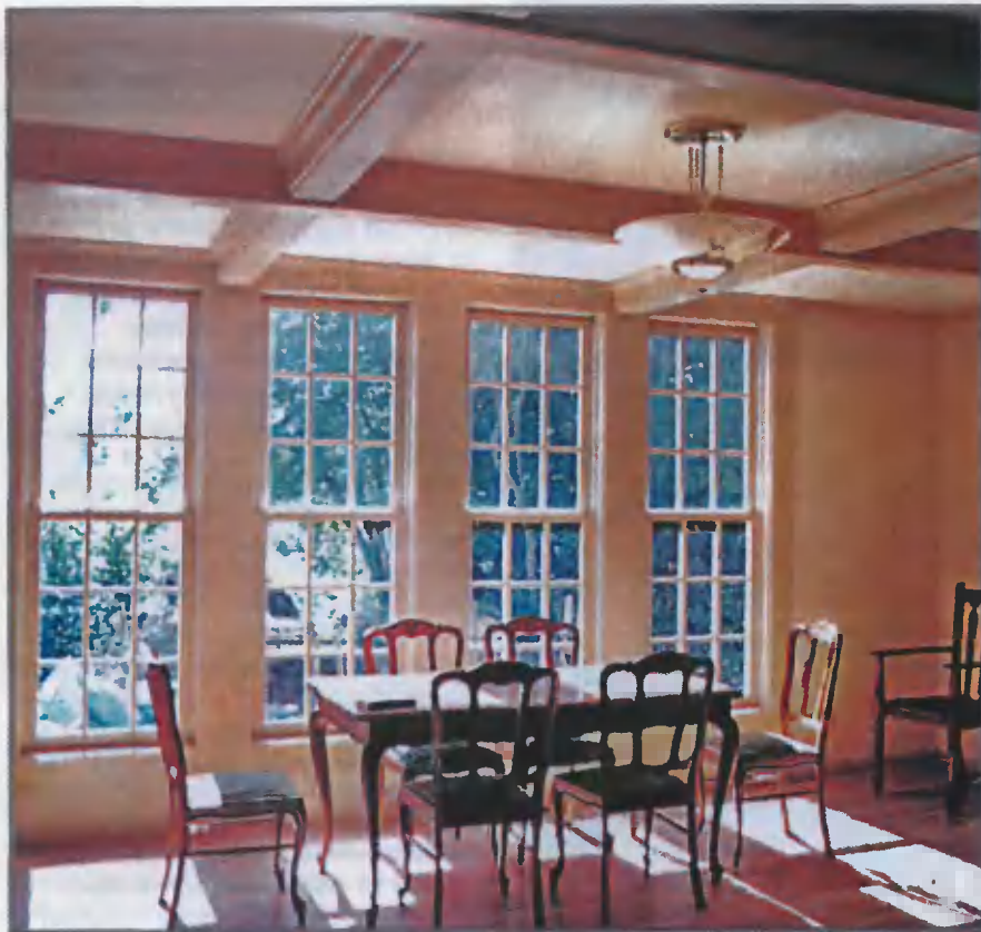
Балки перекрытия опоясывают потолок этой гостиной, поддерживая каркас кессона. В результате получился один утепленный потолочный кессон
